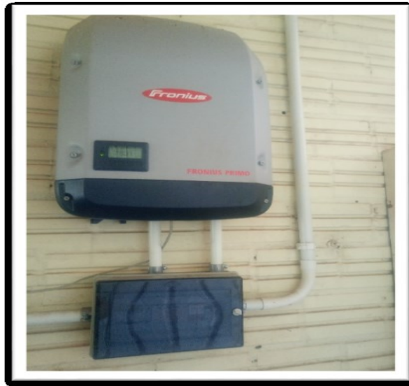
Figura 7 - Inversor do sistema fotovoltaico
