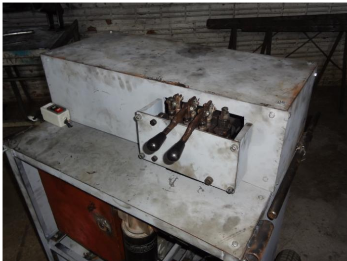
Figura 16 – Comando de válvulas direcionais.
