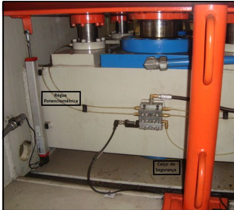
Figura 25: Exemplo de sistema de monitoramento de acordo com a NR 12. Fonte: Metalstar.
