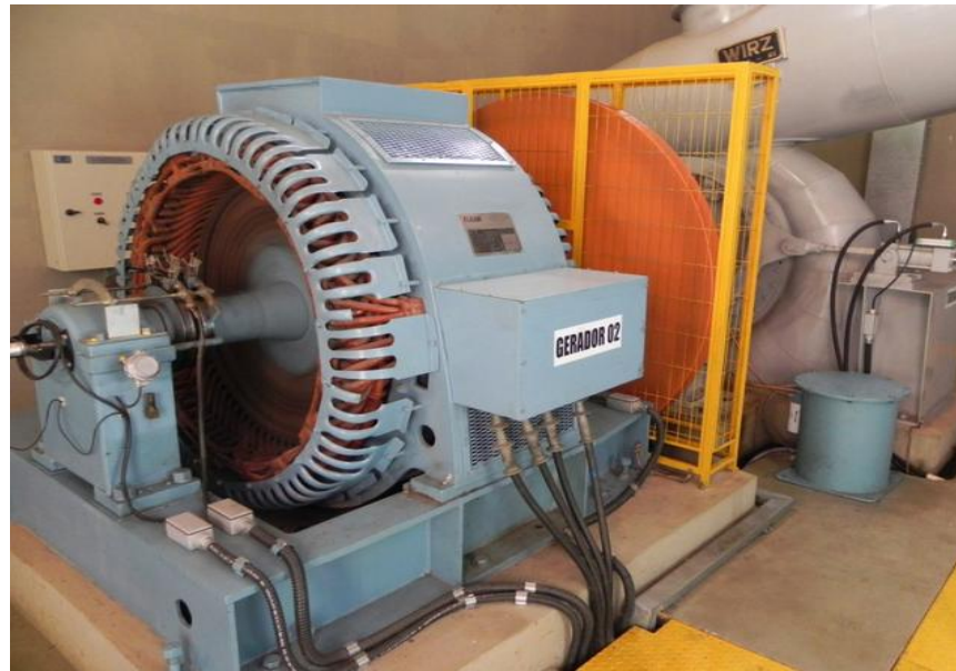
Figura 14: Gerador da PCH de Rio Bonito.
