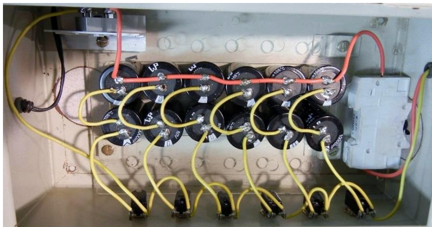
Figura 10: Banco de capacitores. Fonte: Adaptado de Desenvolvimento de um Dispositivo para Soldagem Capacitiva (BECK, 2014).
