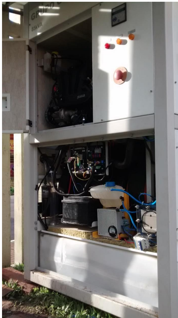
Figura 4: Grupo-gerador a etanol.
