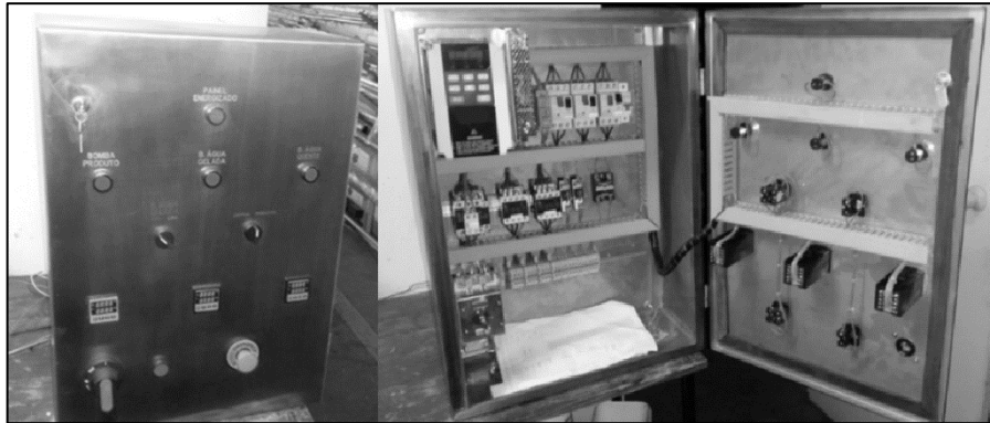
Figura 29: Painel de comando.
