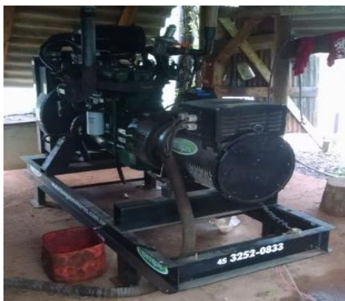
Figura 16 – Grupo-gerador movido a biogás instalado na Granja Gerhardt
