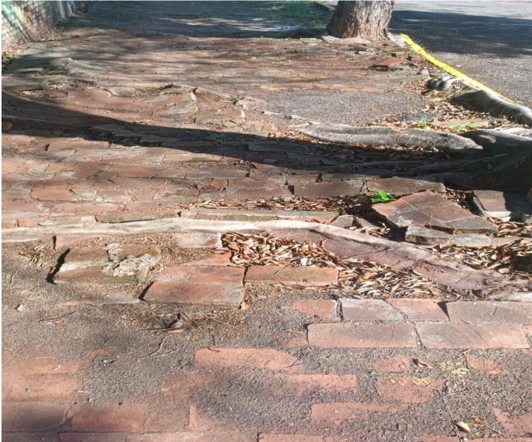
Figura 18 – Situação de raízes expostas.
