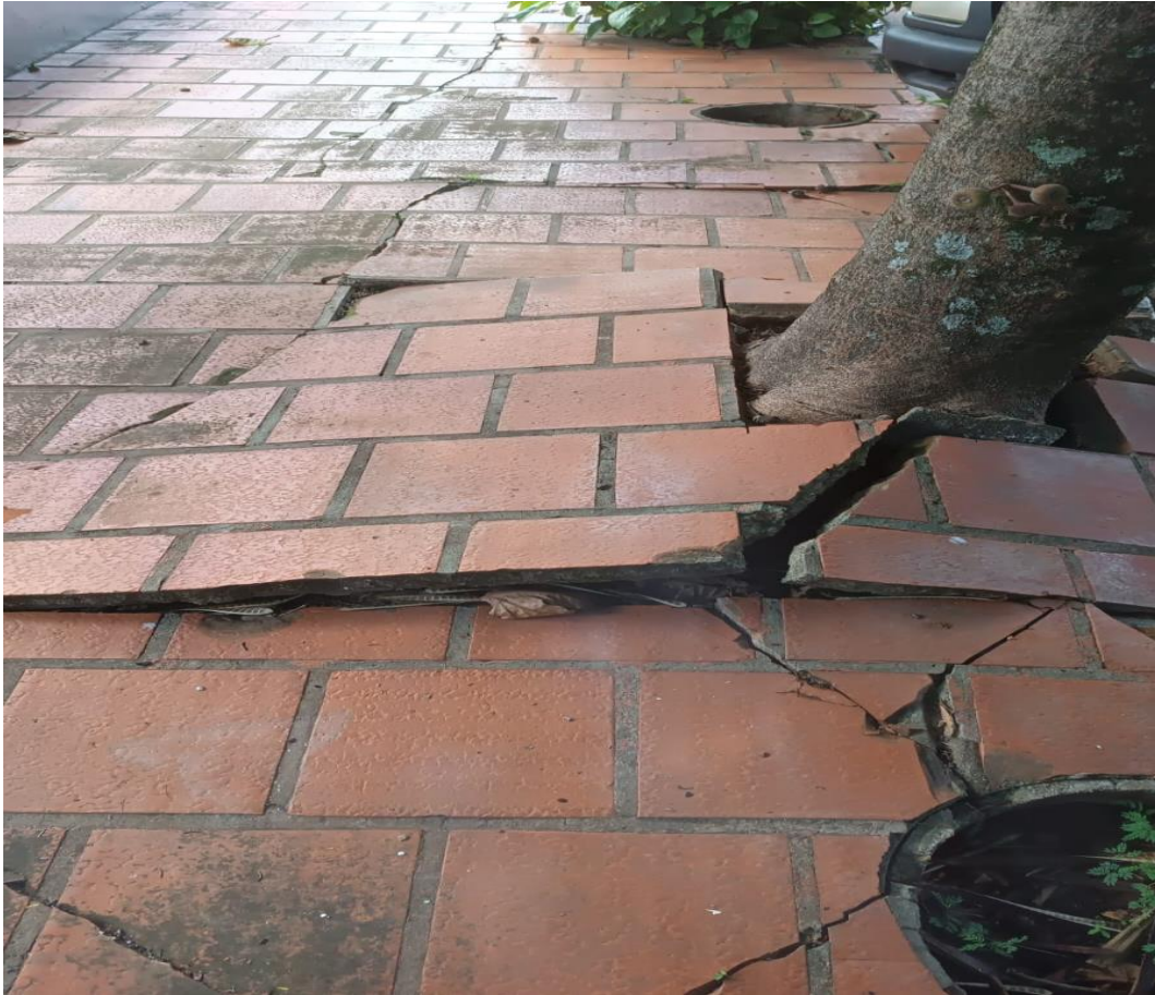
Figura 17 – Situação de raízes expostas.
